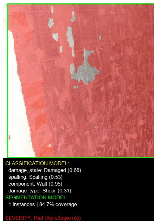
Εικόνα 21. Extensive→Red: Wall, Shear, κάλυψη 84,7% (damage_state confidence 0,68).
