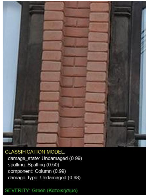
Εικόνα 27. Forced Green: Column, Undamaged (spalling πρόβλεψη αγνοείται).
